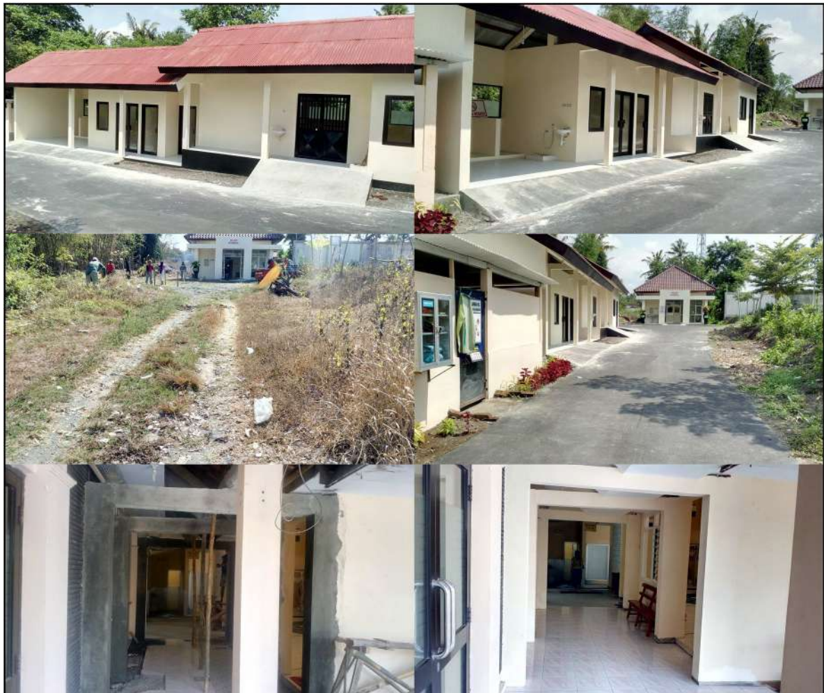
Gambar 4.1 Penataan Lingkungan, Pembangunan TPS dan Pengelolaan Sampah, Rehab Selasar di RSUD Muntilan Tahun 2019
